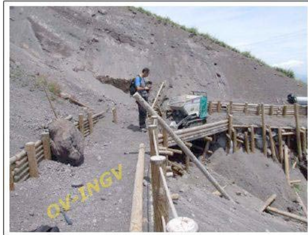
Fig. 6.1.28. - Struttura parzialmente interessata dall'escavazione e accumulo di detriti lungo il sentiero Matrone.
